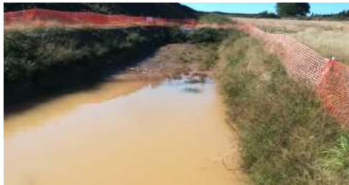
Exemple de bassin d'assainissement provisoire
